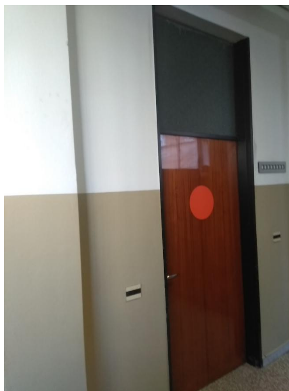
6_Porta deposito piano seminterrato da sostituire
