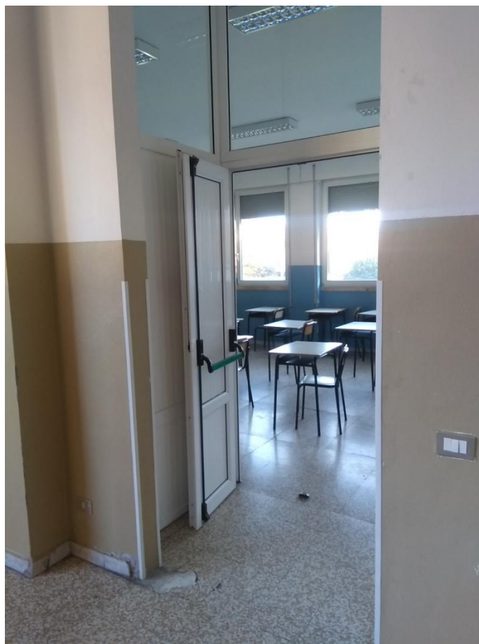
2_Bussole aule da verificare Classe reazione al fuoco
