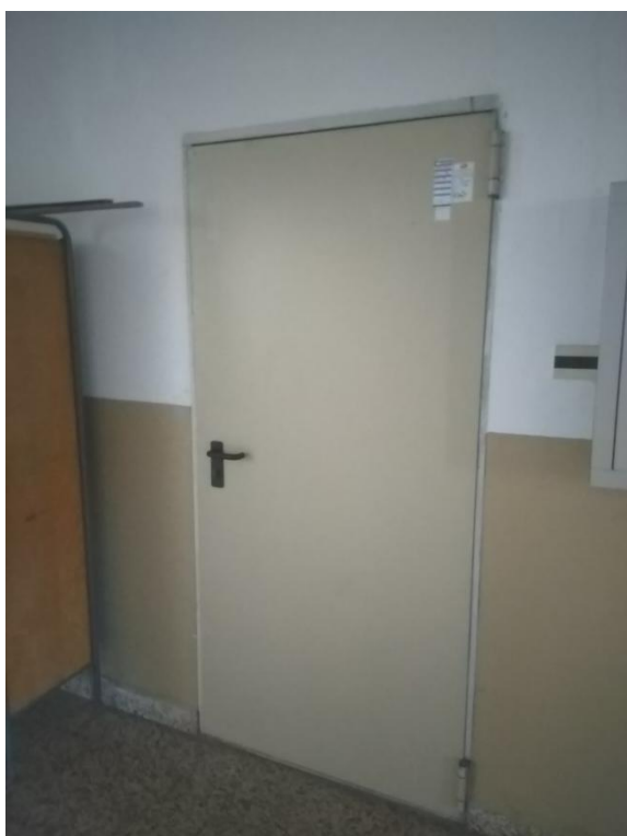
5_Porta deposito seminterrato da sostituire
