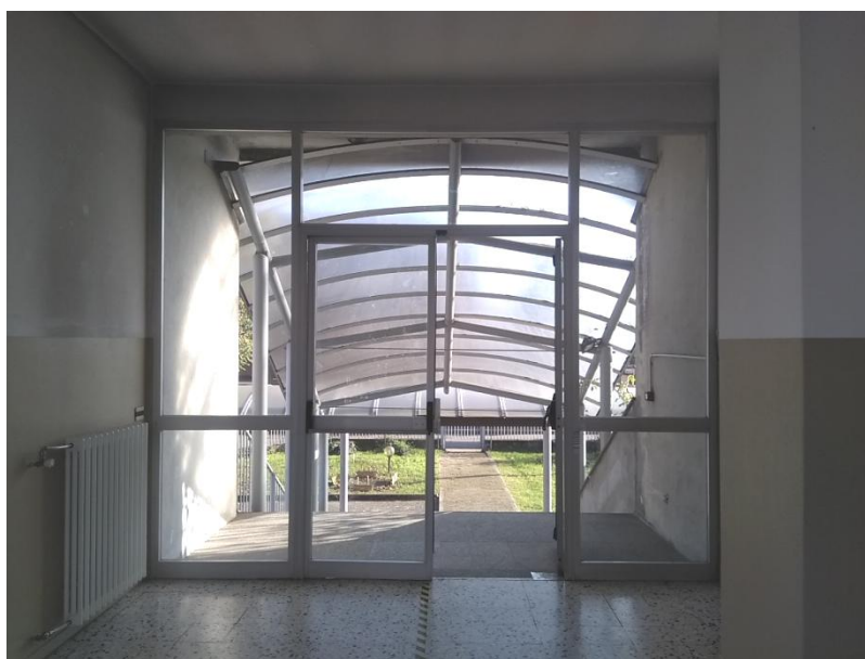
1_Serramento da sostituire
