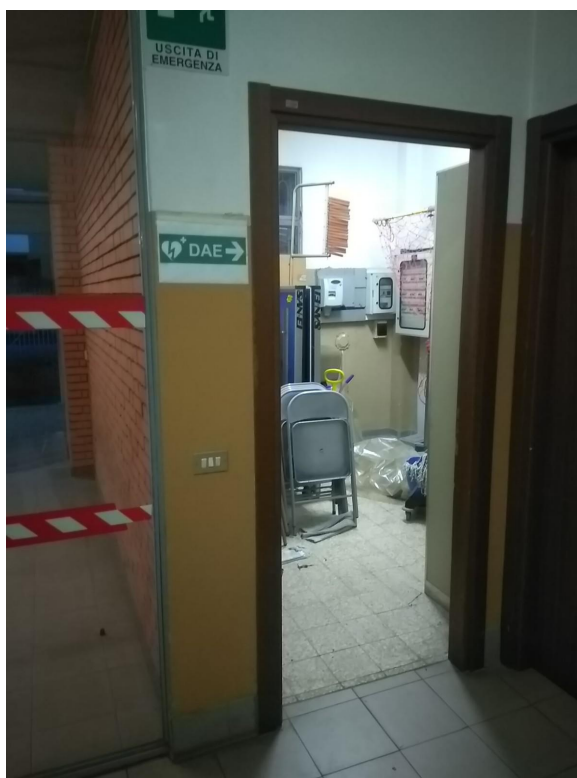
3_Porta deposito spogliatoi da sostituire con EI60
