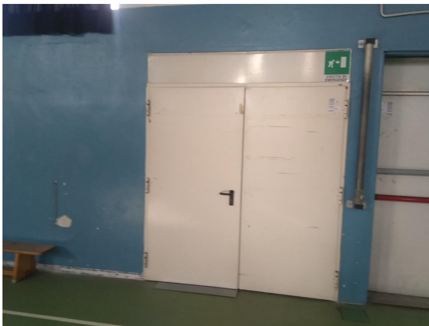
2_Porta EI 60 non omologata da sostituire
