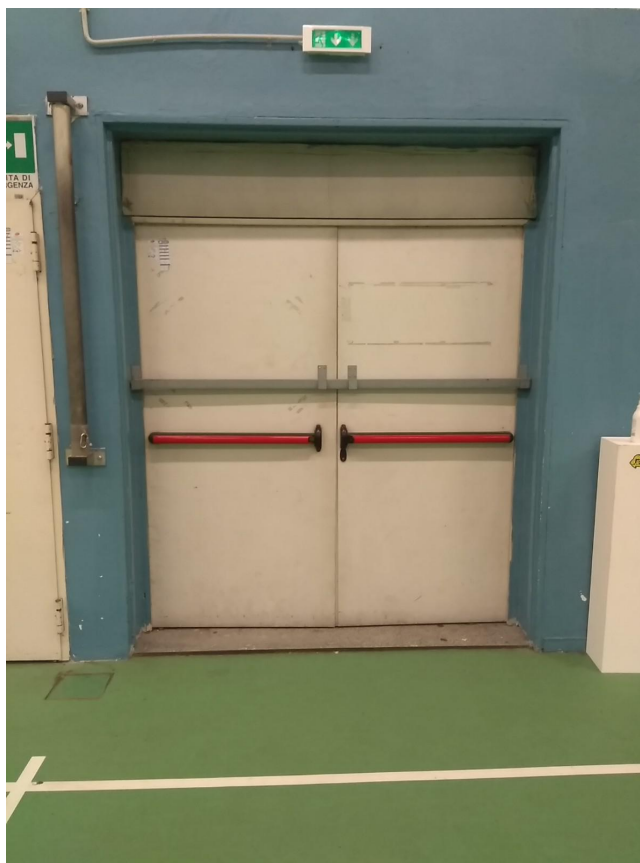
4_Maniglioni antipanico da sostituire
