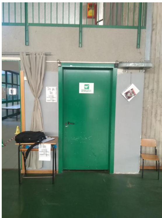
1_Porta deposito da sostituire
